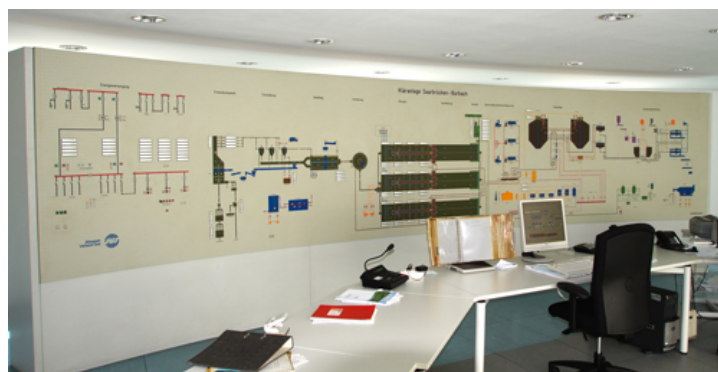
Abbildung 5.2: Zentrale Leitwarte der Kläranlage Saarbrücken-Burbach. 12
