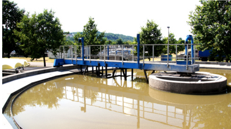
Abbildung 5.3: Vorklärbecken der Kläranlage Saarbrücken-Burbach. 13
