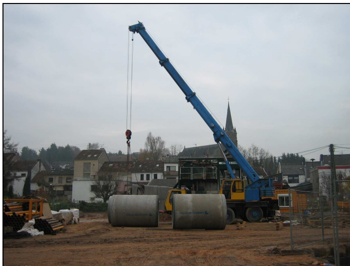
Abb. 22: Blick in südliche Richtung auf die Baustelle in Höhe des Festplatzes und den Ortskern von Differten. Die Dimensionen des innerhalb der Wasserschutzzone III liegenden Baubereiches sind zu erkennen. Rechts im Vordergrund der Aufnahme ist eine weitere Baugrube zu sehen, die sich im Verlauf der geplanten Kanalführung zur Wiesenstraße befindet. In der randlichen Bildmitte wird das geplante Entlastungsbauwerk, daneben das erforderliche Abwasserpumpwerk entstehen. Die Bist verläuft von rechts nach links zwischen Baustelle und der Bebauung.
