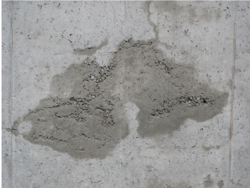
Abbildung 1.1: Oberflächenoffenes Kiesnest in einer Stahlbetonwand
