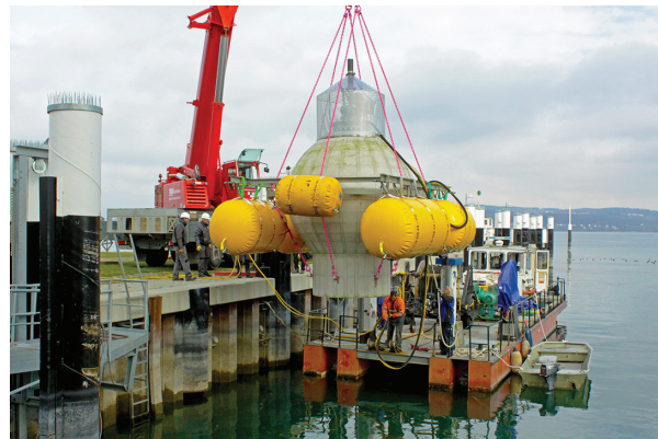
Abb. 4 Beim Projekt StEnSea wurde im November 2016 ein Testmodell eines Hohlkugelspeichers mit 3 m Durchmesser, in den eine Pumpturbine eingebaut ist, auf dem Grund des Bodensee installiert ([11], Bild: Fraunhofer IEE).
